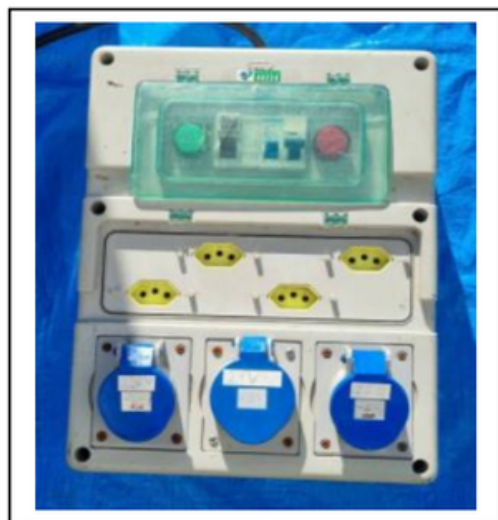
Quadro de comando com DR
